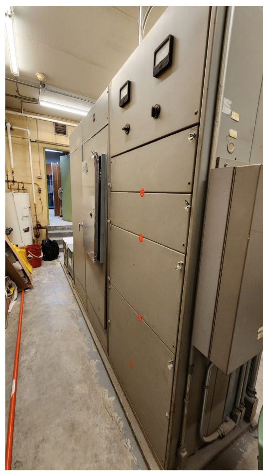
PHOTO DU CABINET ARRIÈRE DU CENTRE DE DISTRIBUTION (SECTION 5,6 ET 7)
