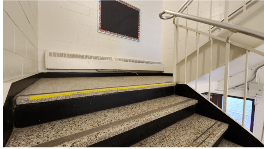
TYPIQUE CABINET DE CHAUFFAGE ESCALIER
