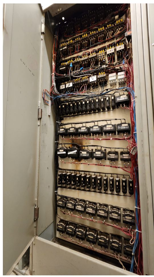
PHOTO DU CABINET DE CONTRÔLE DU CHAUFFAGE (SECTION 7) VOIR NOTE 3
