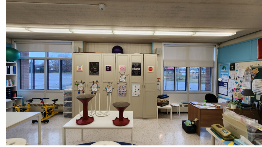
TYPIQUE CABINET DE CHAUFFAGE DANS UNE CLASSE
