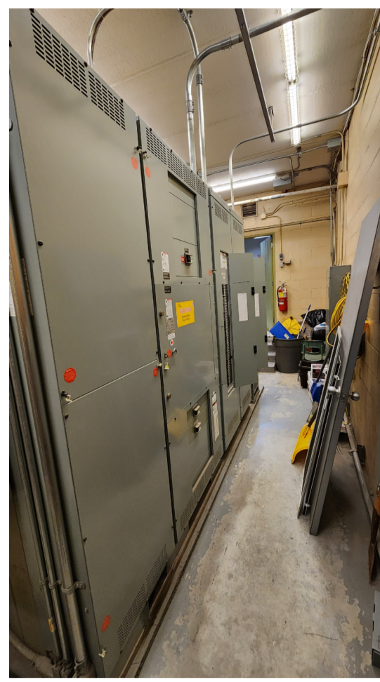
PHOTO DU CABINET DU CENTRE DE DISTRIBUTION (SECTION 1,2,3 ET 4)
