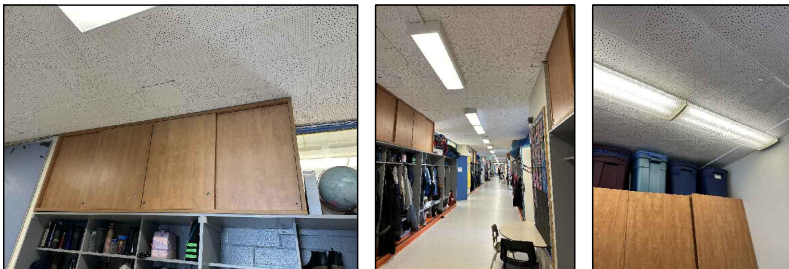
PHOTOS ARMOIRES EXISTANTES RDC
