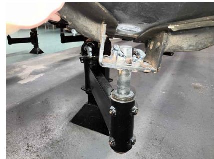
PHOTO 3: MÉCANISM ENDOMMAGÉE À REMPLACER. NOUVEAU MÉCANISM FOURNIS PAR CLIENT. INTALLATION PAR ENTREPRENEUR.
