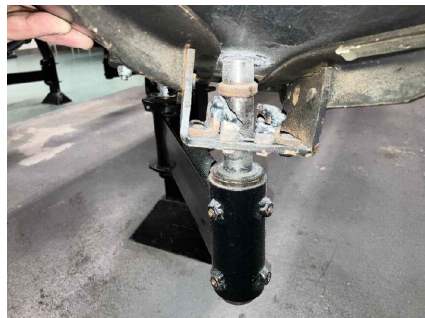
PHOTO 4: MÉCANISM ENDOMMAGÉE À REMPLACER. NOUVEAU MÉCANISM FOURNIS PAR CLIENT. INTALLATION PAR ENTREPRENEUR.
