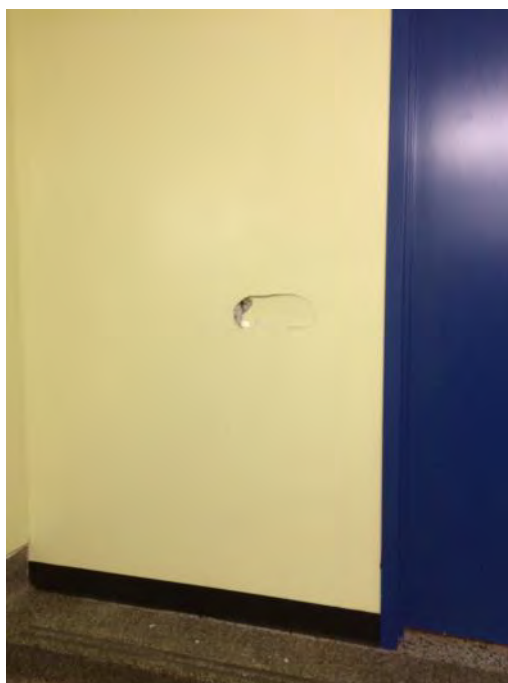
Photo 4 - Gypse sur le mur au rez-de-chaussée qui ne contient pas d'amiante, près du local 262
